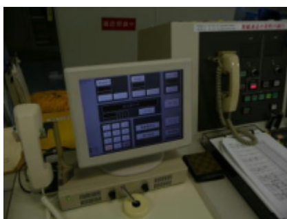
デジタル列車無線地上装置（運輸指令所）
