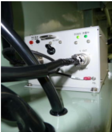
防護無線機電源(二重化改造)
